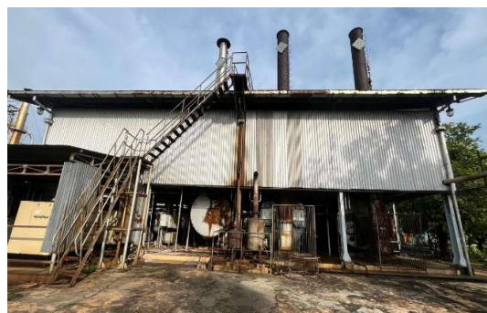
Gambar 2. Unit Utilitas (Penunjang Kilang)
