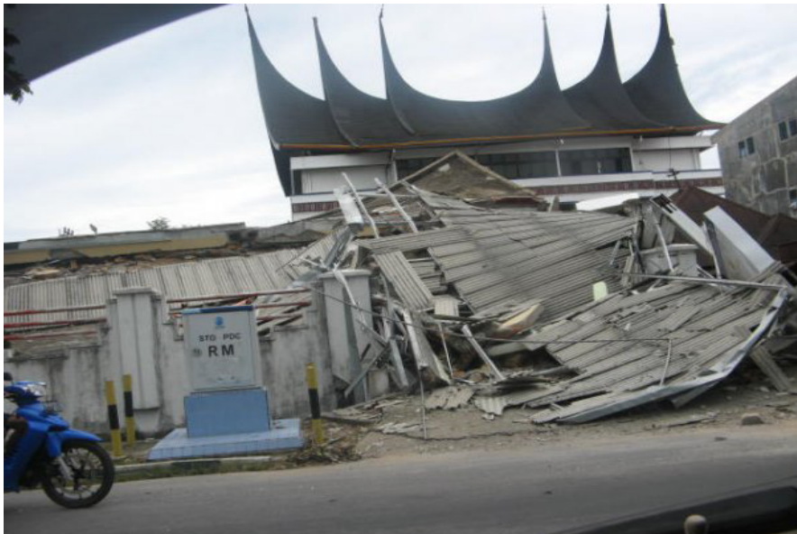
Gambar 4. Bangunan runtuh akibat tidak kuat menahan kuatnya guncangan Gempa Bumi Padang yang berkekuatan 7 SR, 30 September 2009. Foto: Yudhicara, Badan Geologi.
