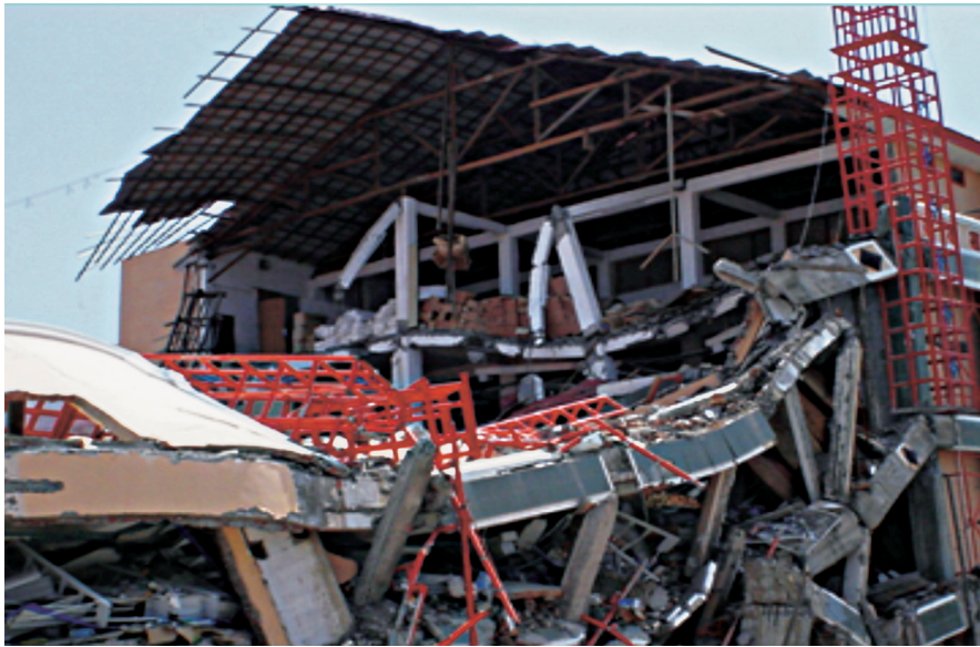
Gambar 3. Salah satu bangunan pertokoan di Banda Aceh, NAD, hancur akibat Gempa Bumi Aceh, 26 Desember 2006 berkekuatan 8,9 SR, salah satu gempa bumi yang mempunyai intensitas hampir maksimal yang pernah terjadi sepanjang sejarah. Foto: Cahya Patria, Badan Geologi.
