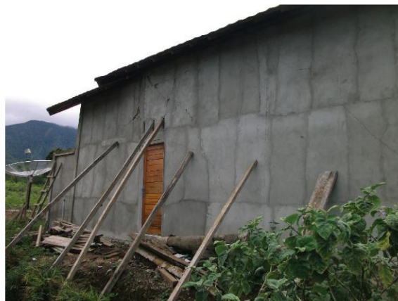
Gambar 4. Kerusakan rumah penduduk akibat gempa bumi 6 Desember 2017 di Desa Tabeak Blau, Kecamatan Lebong Atas, Kabupaten Lebong. (Sumber: Dokumentasi pribadi, 2018)
