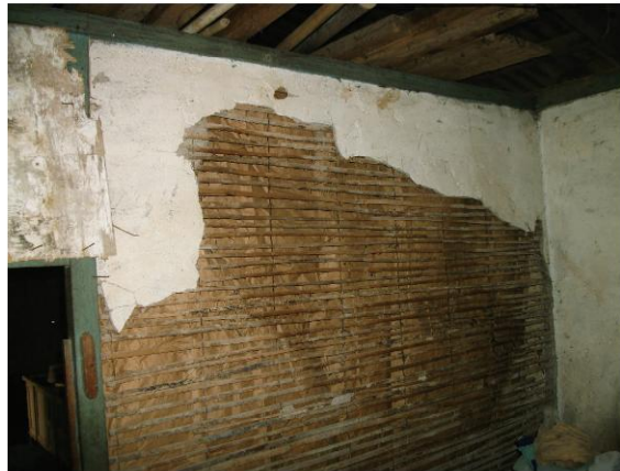
Gambar 6. Lepasnya plesteran dinding rumah penduduk di Desa Gunung Alam, Kecamatan Pelabai akibat gempa bumi 6 Desember 2017. (Sumber: Dokumentasi pribadi, 2018)
