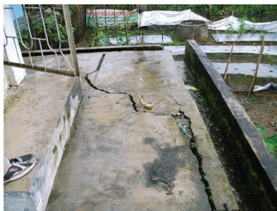
Gambar 5. Retakan tanah di kantor Camat Lebong Atas akibat gempa bumi 6 Desember 2017. (Sumber: Dokumentasi pribadi, 2018)
