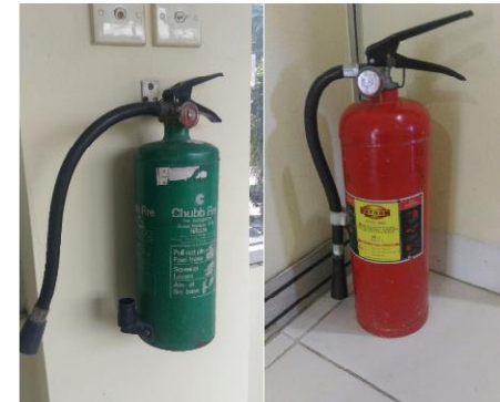
Gambar 5 APAR Halon dan Penempatan APAR yang tidak standar (Sumber: Dokumentasi pribadi)
