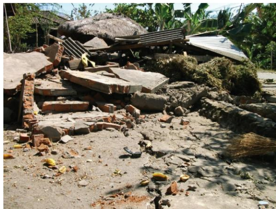
Gambar 7. Sesar gempa bumi minor akibat kejadian gempa bumi, 5 Agustus 2018 mengakibatkan robohnya bangunan di Desa Sambik Bengkol, Kecamatan Gangga, Kabupaten Lombok Utara (Dokumen Penulis).
