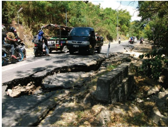
Gambar 8. Retakan tanah akibat kejadian gempa bumi, 5 Agustus 2018 mengakibatkan kerusakan jalan di Kecamatan Gangga, Kabupaten Lombok Utara (Dokumen Penulis).
