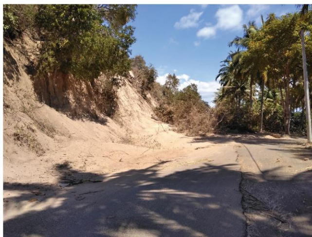
Gambar 11. Gerakan tanah dipicu kejadian gempa bumi, 5 Agustus 2018 menutup jalan raya di Kecamatan Kayangan, Kabupaten Lombok Utara (Dokumen Penulis).
