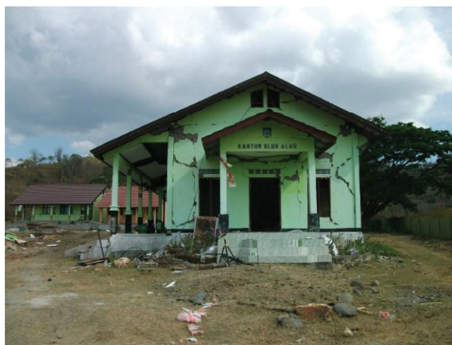
Gambar 13. Bangunan SLB rusak berat di Kecamatan Alas, Kabupaten Sumbawa akibat gempa bumi, 19 Agustus 2018 (Dokumen Penulis).
