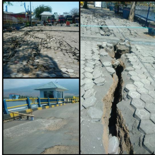
Gambar 14. Retakan tanah berarah N 45°E mengakibatkan kerusakan jalan di Pelabuhan Kayangan, Desa Labuhan Lombok, akibat gempa bumi, 19 Agustus 2018 (Dokumen Penulis).
