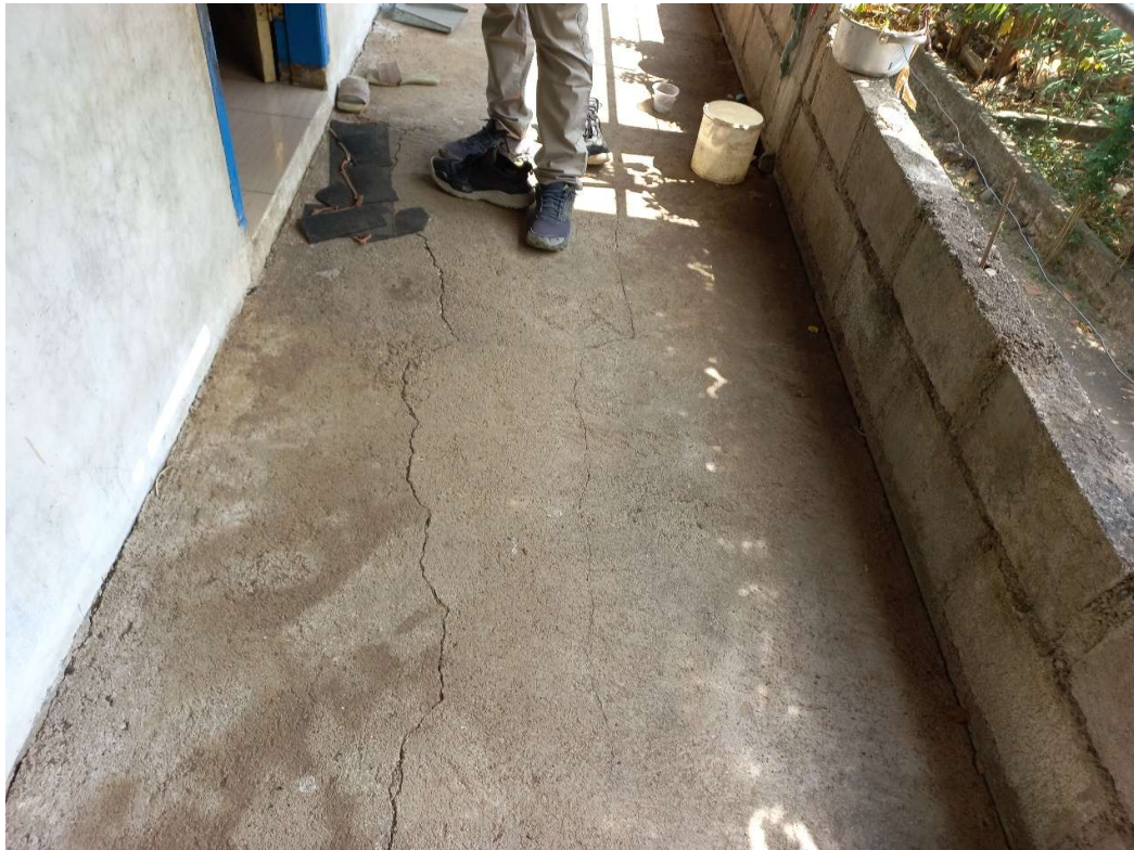
Gambar 6 Retakan lantai rumah penduduk akibat gempa bumi tanggal 28 Mei 2024 di Dusun Krajan, Desa Borang, Kecamatan Arjosari.
