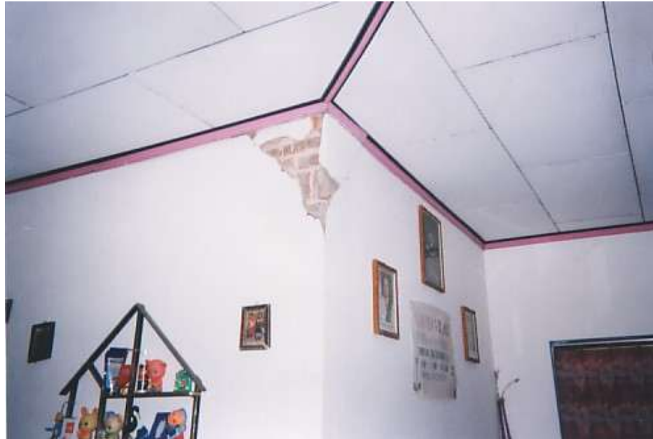
Gambar 2 Kerusakan rumah penduduk akibat gempa bumi tahun 2003 di RT 2, RW 1, Desa Sambong, Kec. Pacitan, Kab. Pacitan (Supartoyo dkk., 2003).
