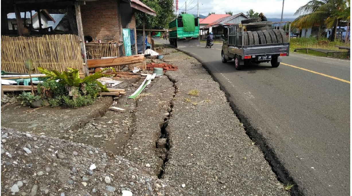
Gambar 4 Retakan tanah tipe lateral spreading di daerah Tapalang, Kabupaten Mamuju akibat gempa bumi tanggal 15 Januari 2021.
