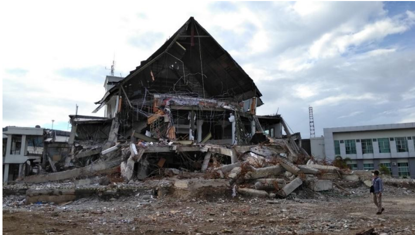
Gambar 2 Kantor Gubernur Sulawesi Barat yang mengalami rusak berat akibat gempa bumi tanggal 15 Januari 2021
