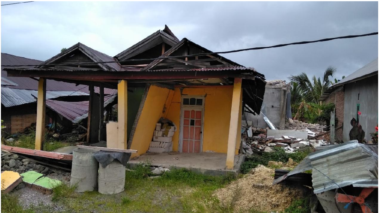
Gambar 5 Likuefaksi mengakibatkan kerusakan rumah penduduk di Desa Maketta, Kecamatan Malunda, Kabupaten Majene, akibat gempa bumi tanggal 15-1-2021.
