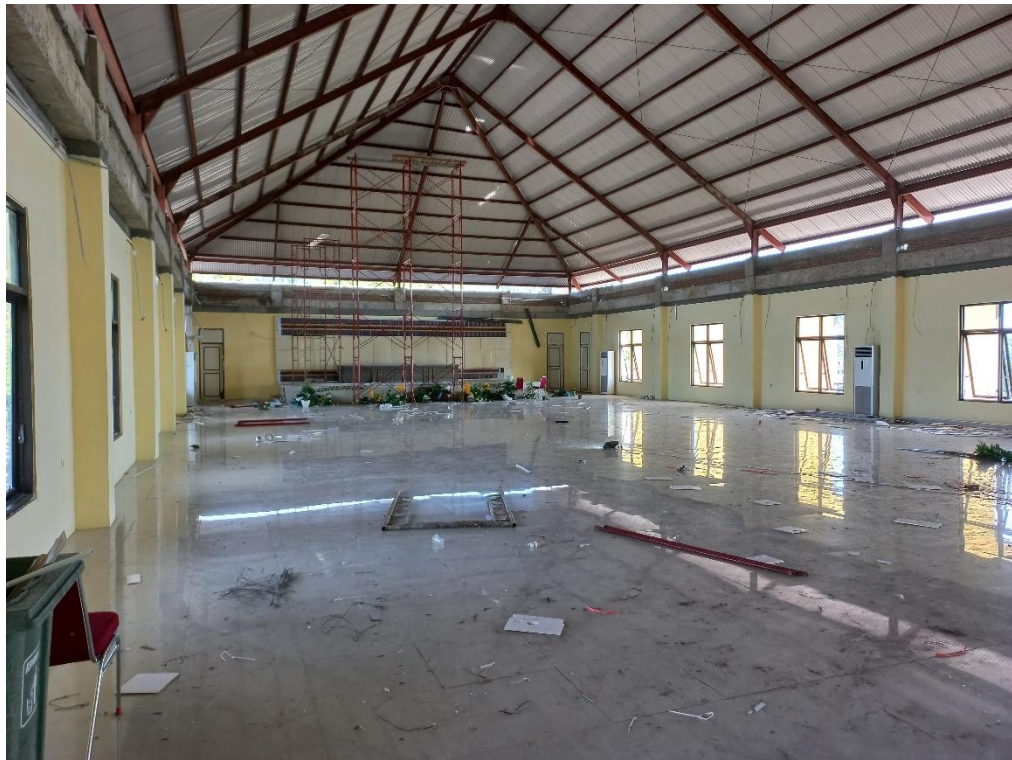
Gambar 8 Puing-puing runtuhannya plafon Gedung PKK Provinsi Sulawesi Barat akibat gempa bumi tanggal 8 Juni 2022.
